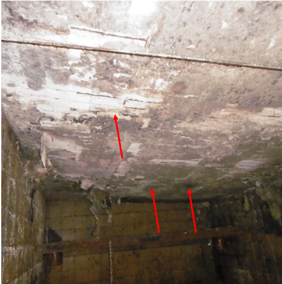
Fot.3 Widoczne ugięcia pęty stropodachu i miejsca korozji
