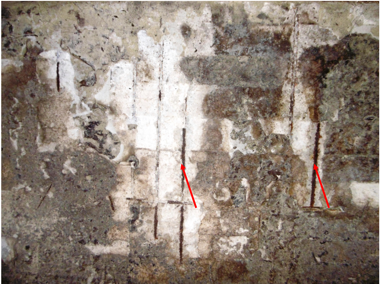
Fot.4 Widoczne odsłonięte i skorodowane pręty zbrojeniowe płyty stropowej
