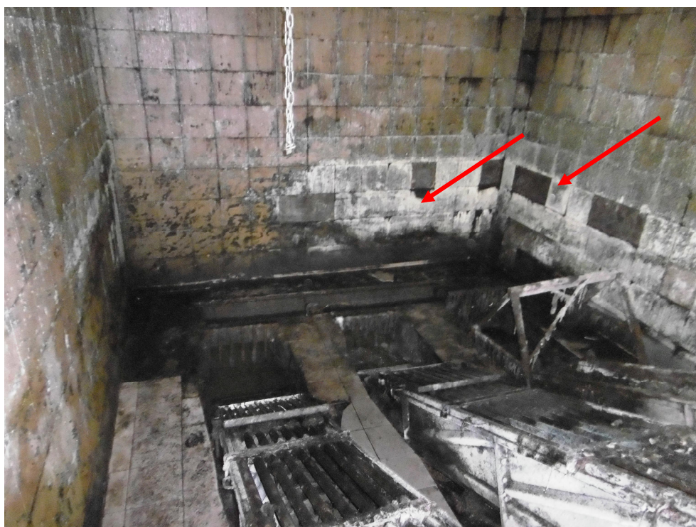
Fot.2 Widoczne przebarwienia, wykwity biologiczne na okładzinach ścian wewnętrznych
